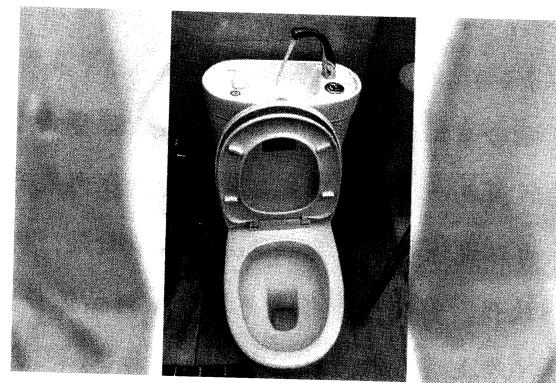
洗手后的水直接流入水箱,用来冲洗马桶,高效率地使用水资源。(摄/王绥喜)
